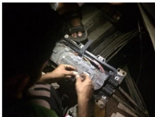
Gambar 16. Penyusunan Core Pada Splice Tray
