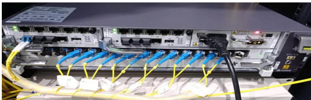
Gambar 5. Perangkat OLT yang tercolok Patchcord
