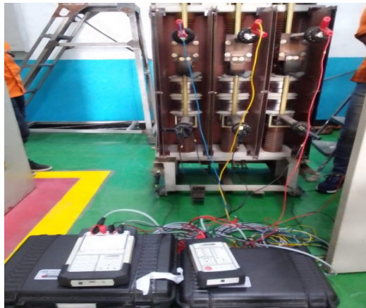
Gambar 5 Gambar Alat Uji Keserempakan PMT
